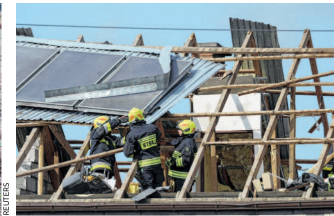
Kuća u Poljskoj čiji je krov uništio oboreni ruski dron
