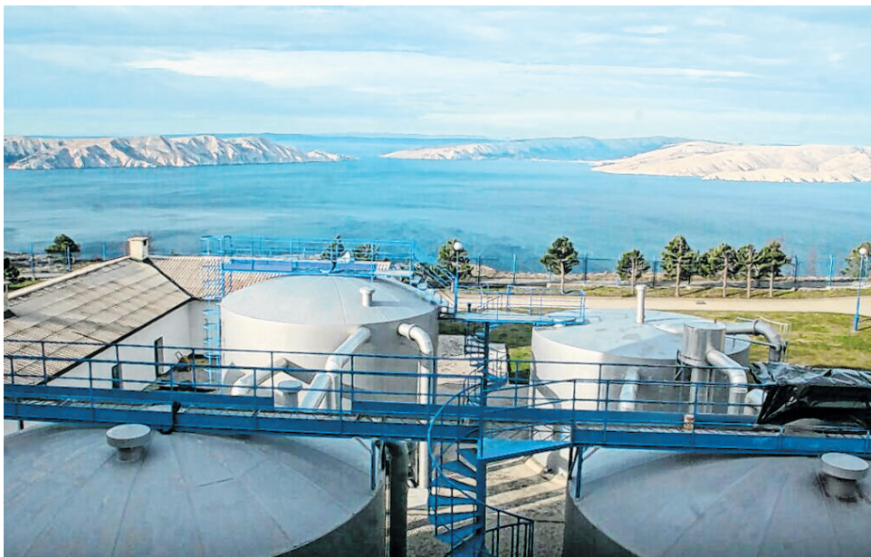
Uređaj za pročišćavanje Vodovoda Hrvatsko primorje na Hrmatinama
