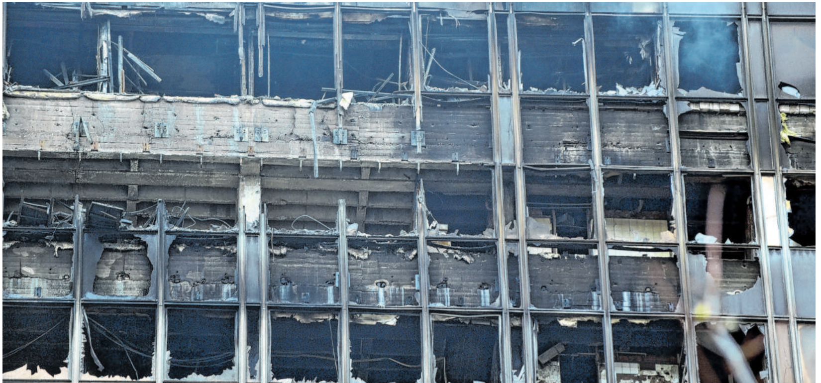
Šteta na Vjesnikovom neboderu je potpuna, slijedi odluka hoće li se zgrada rušiti ili obnavljati
