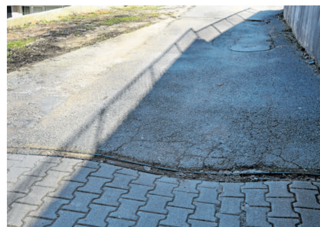
Predstavnik zgrade kaže da su vozila Čistoće oštetila prilaz
