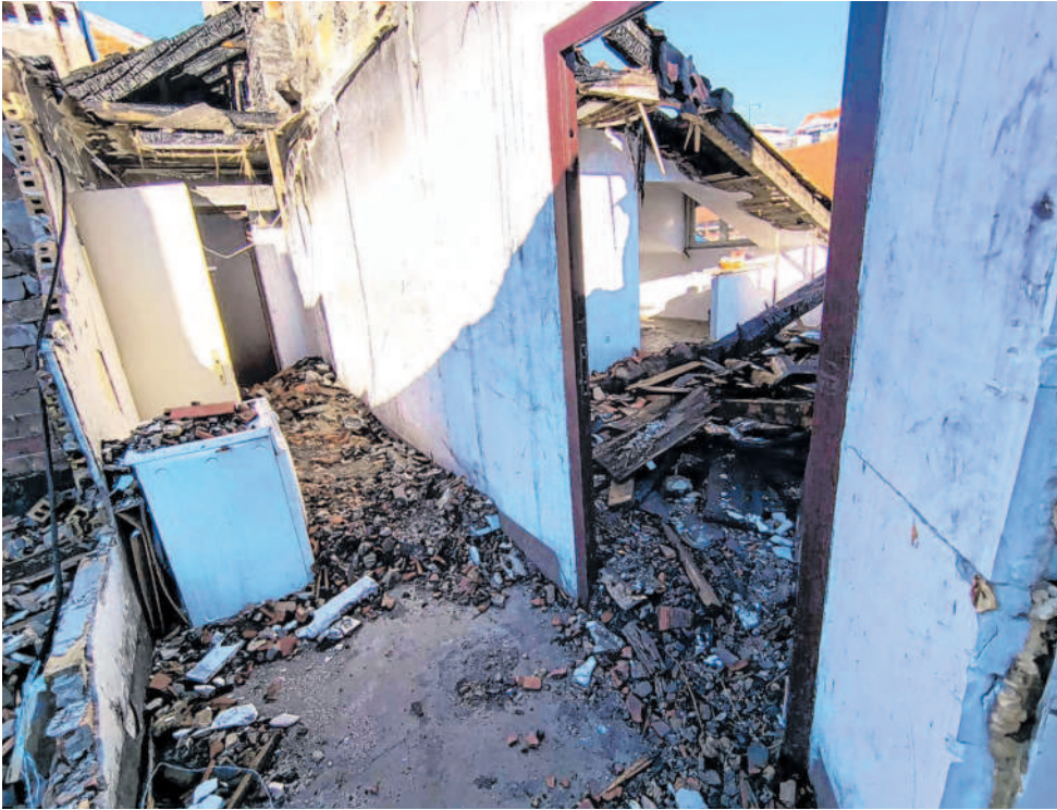
Zgrada je i dalje djelomično nezaštićena, svaka nova kiša uzrokuje dodatnu štetu, a rizik za sigurnost ljudi i imovine je velik
