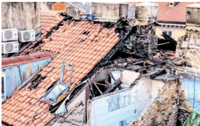
Potpuno izgorjeli krov
